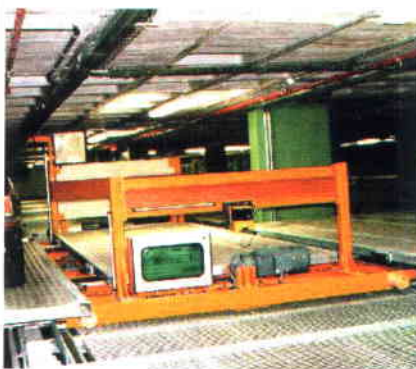
Las lanzaderas realizan el transporte horizontal de los vehículos
